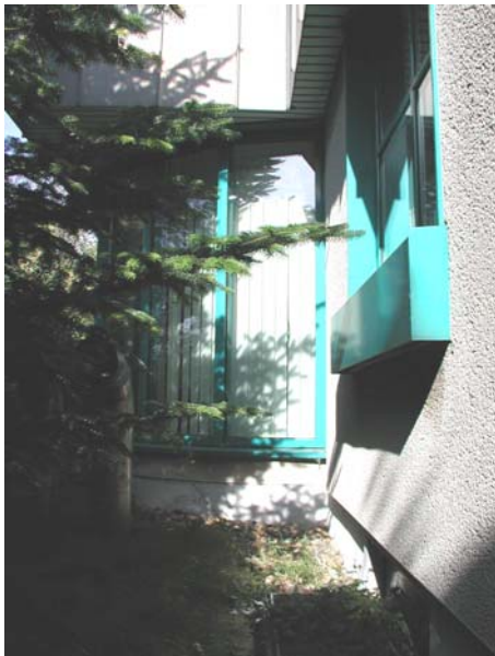
Abb. 11.6: VEW-Regionalzentrum Wambel. Links ist das Fortluftrohr der Wärmepumpenanlage zu erkennen. Foto: W. Wagner
