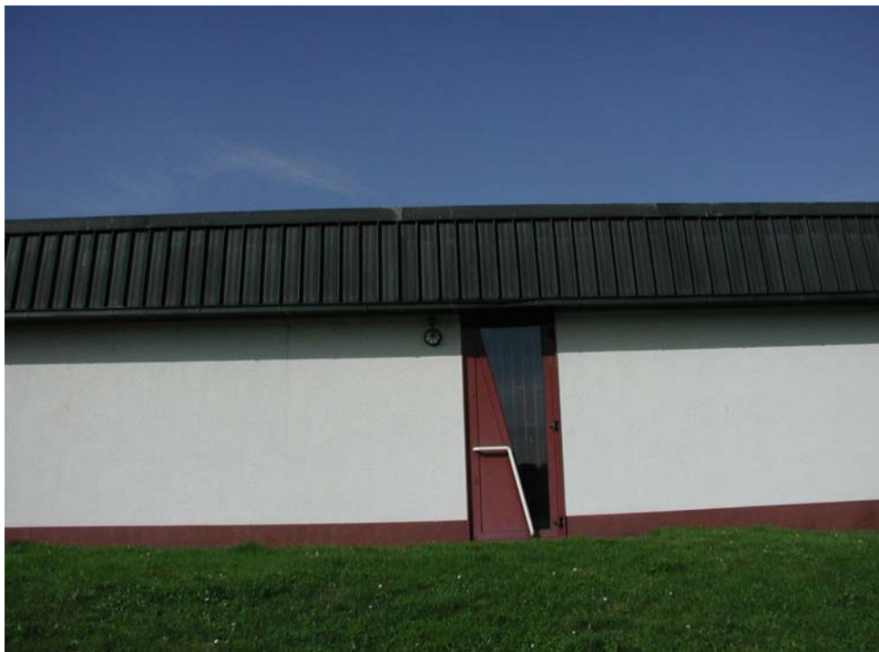
Abb. 9.4: VEW-Regionalzentrum Brechten, Attikablende als Wärmetauscherfläche, Foto: W. Wagner
