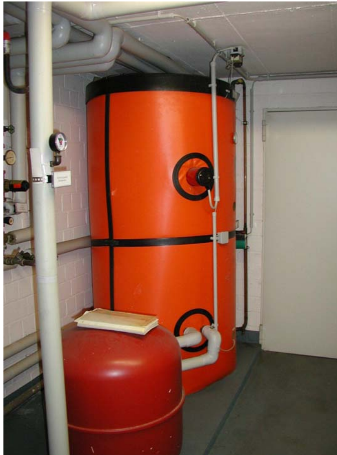
Abb. 11.4: VEW-Regionalzentrum Wambel, TWW-Speicher, Inhalt 1.000 Liter, mit eingebauten Heizflanschen. Foto: W. Wagner
