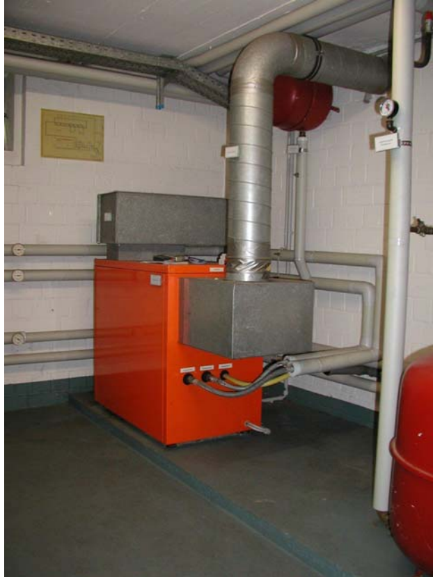
Abb. 11.5: VEW-Regionalzentrum Wambel, Wärmepumpenanlage, Leistung: 3,5 kW, Foto: W. Wagner
