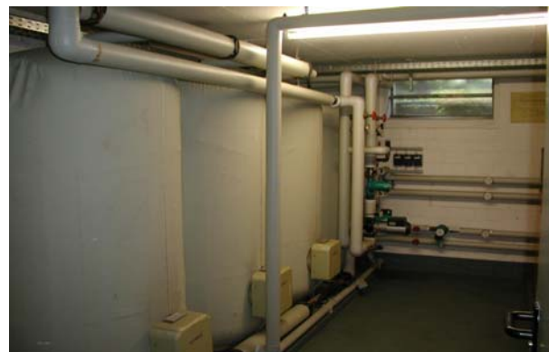
Abb. 11.10: VEW-Regionalzentrum Wambel, 3 Pufferspeicher je 700 l mit 9 kW Elektroheizflansch. Foto: W. Wagner
