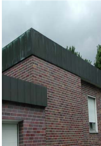
Abb. 11.13: Standardisierte Attikablende eines Kaldaches mit einer Kupferblende in Stehpfalzausführung, in Dortmund. Foto: W. Wagner
