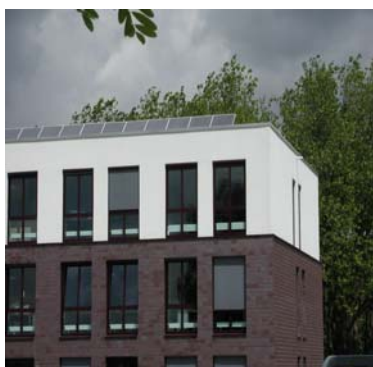
Abb. 2.3: Flachdach mit Photovoltaik-Elementen, Foto: W. Wagner
