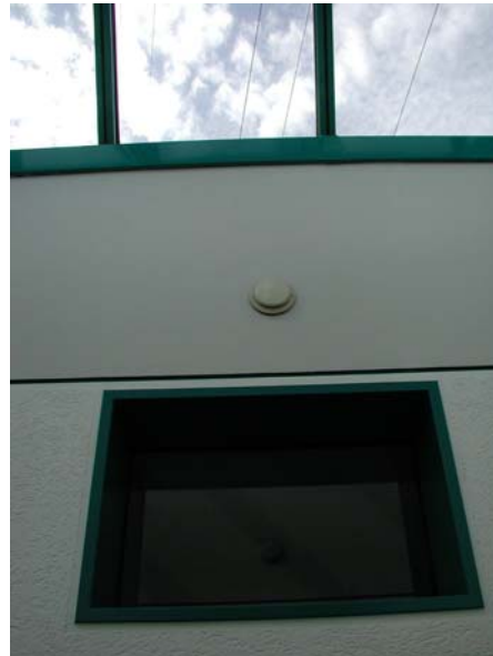
Abb. 11.7: VEW-Regionalzentrum Wambel. Lichtflur mit der zentralen Absaugöffnung der Abluftanlage. Foto: W. Wagner
