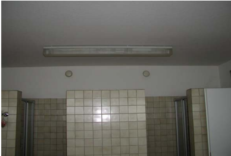
Abb. 11.8: VEW-Regionalzentrum Wambel, Sozialbereich Duschraum. Über den Duschen ist die Absaugung zu sehen (Tellerventile). Foto: W. Wagner
