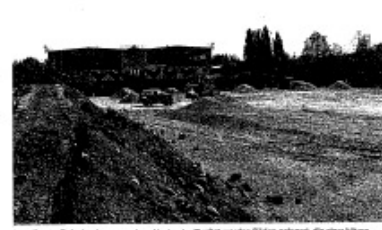
Im offenen Zwischenlager an der Hückarder Straße werden Böden gelagert, die einen hohen Gehalt an organischen Stoffen aufweisen. Böden, die organisch stark belastet sind, verbleiben ein Jahr bei weiterer thermischer Behandlung.
