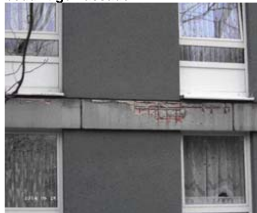
Abbildung 4: „Schlechte“ sanierungsbedürftige Fassade
