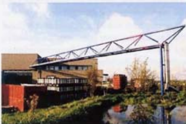
Abb. 7-29 Ableitung der Dachabflüsse in höher gelegenen Flächen mithilfe von Rohrbrücken
