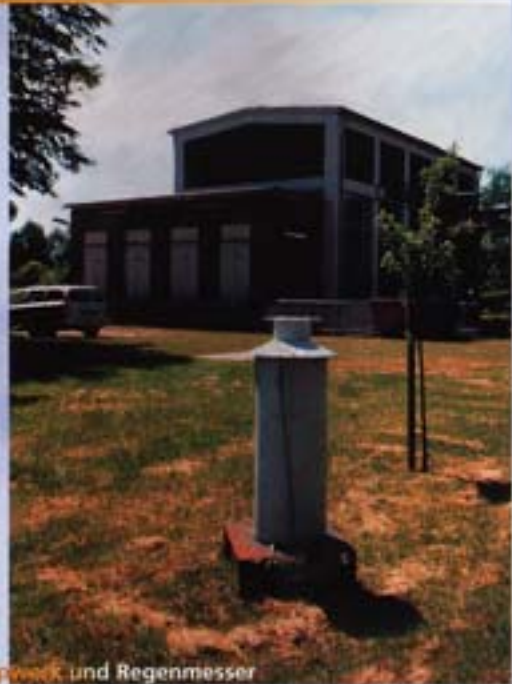
Pumpwerk und Regenmesser
