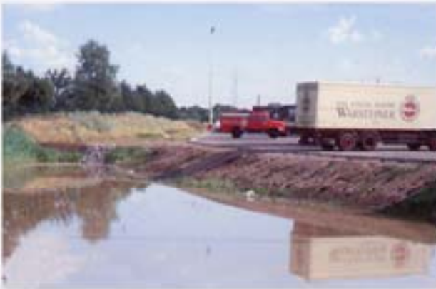
Abb. 7-44 Entwässerung befestigter Flächen in Versickerungsmulden ohne schützende Vegetationsdecke ziehen Verschlammung und langanhaltende Wasserstände nach sich
