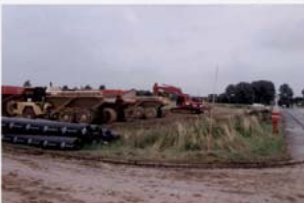
Abb. 7-46 Verdichtung zukünftiger Versickerungsflächen durch schwere Baufahrzeuge
