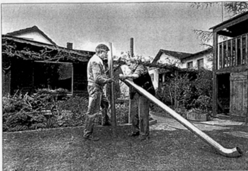
Die Mulden sind fertig, jetzt fehlen noch die Rohre für das Regenwasser. Die Nachbarn Alfred Schlatt (l.) und Helmut Meschke beteiligen sich am Modellprojekt. Foto: Piontek
