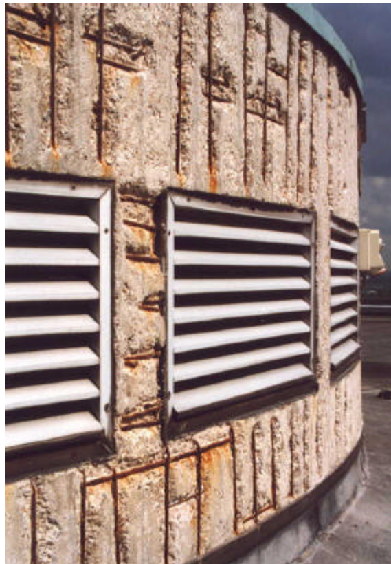
Bild 2: Bewehrungstähe, die nach Carbonatisierung des Betons ihre Betondeckung durch Rosttreiben abgedrückt haben
