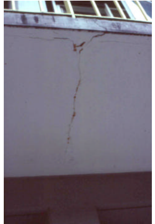
Bild 13: Trennriß in Balkonplatte
