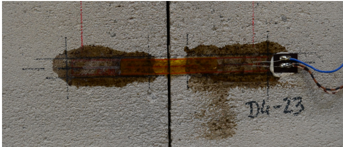
Bild 4.19 Modifizierte Dehnmessstreifen auf Stoßfuge
