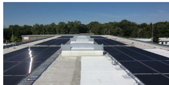
Photovoltaikanlage auf dem Dach der Zeller Kälte- und Klimatechnik GmbH in Herten
