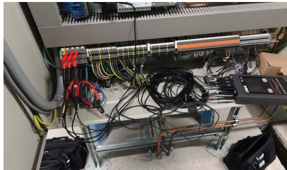
Abbildung 5.11: Messung an einer el. Unterverteilung
