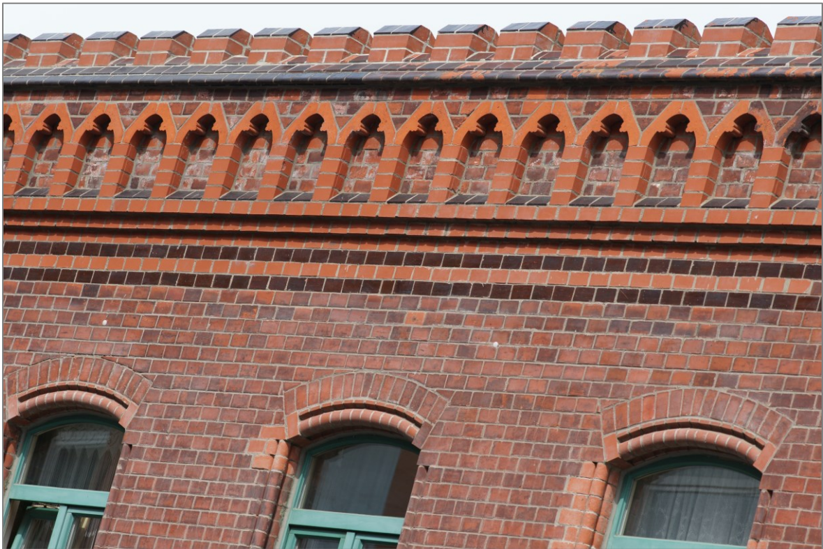
Abbildung 58 Der gerade Abschluss des Anbaus in der 35 Posthornstraße 9 erscheint erneuert worden zu sein. Dabei ist den Maurern der Fehler unterlaufen, das Fensterstabwerk bis zum Sturz aufzuführen, statt es mit eckigem Kämpferstein enden zu lassen (linke Laibungen des mittleren und des rechten Fensters)
