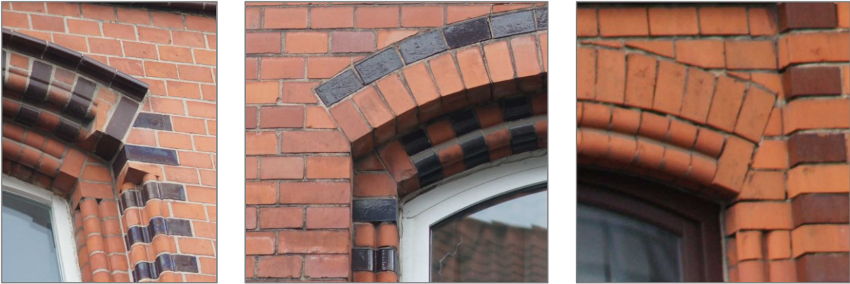
Abbildung 105 Details Segmentbogen 2. 08 Gellert 46, 02 Oeltzenstraße 22, 01 Lavesstraße 79
