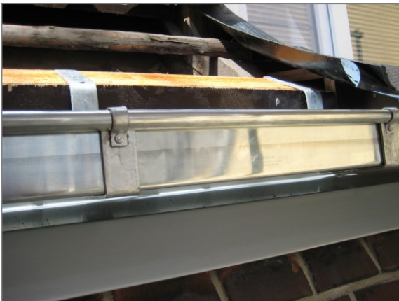
Abbildung 142 Unterkonstruktion Keilbohle (helles Holz) dient zur Befestigung der Rinneisen und der Kastenrinne mit Unterblech
