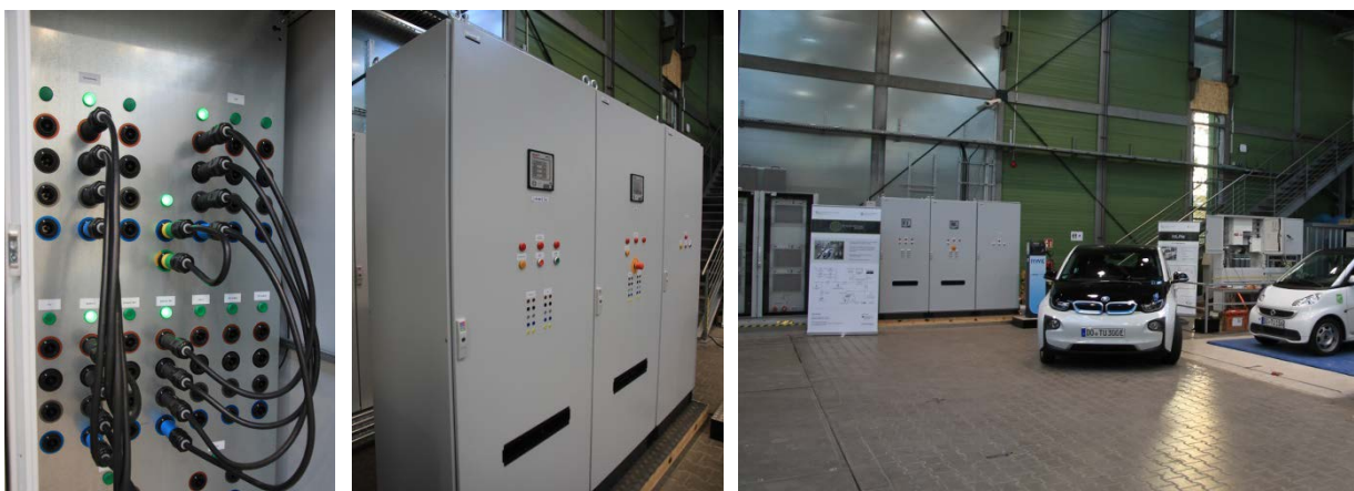
Impressionen aus dem SGTL Labor: links Verteilerschrank Mitte: AC und DC Verteilerschränke
