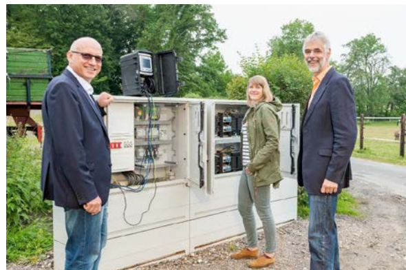
Pilotanlage im Netzstrang des Projektpartners (Quelle: Elektro-Bauelemente GmbH)
