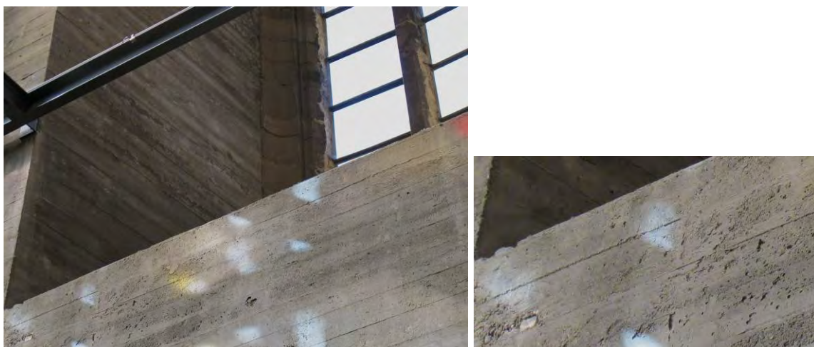
Abb. 20 – Baunaht Turm. Blick auf tastferne Fenstervorlage des westlichen Turmfensters als Beleg der Übergangsnah Beton und Sandstein. Rechts Ausschnitt aus Abb. 20 mit Zoom auf Kieselsteineinschluss. (© fb)
