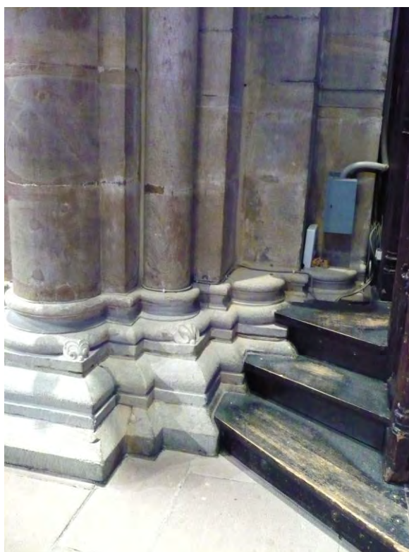
Abb. 15 – Baunaht nordöstlicher Vierungspfeiler. Basis. Ebenfalls kontrastreicher Materialwechsel zwischen steinerne Naht und Chorgestühl vorhanden, jedoch mit störender Elektronik. (© ak)
