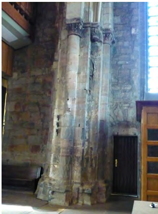
Abb. 25 a – Bauwerknarbe nordwestlichen Wandpfeiler neben dem Turmaufgang im nördlichen Seitenschiff. Standort erstes Joch des nördlichen Seitenschiffs. (© ak)
