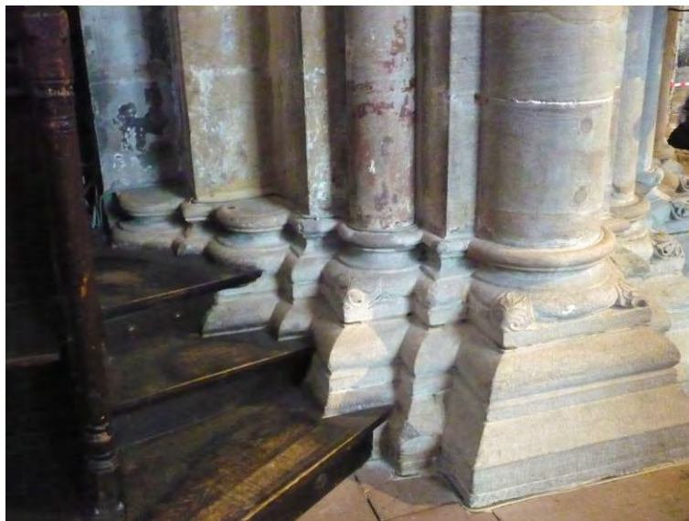
Abb. 5 – Baunaht südöstlicher Vierungspfeiler. Basis. Runde Freiflächen als tastbarer Beleg der Baunaht. (© ak)
