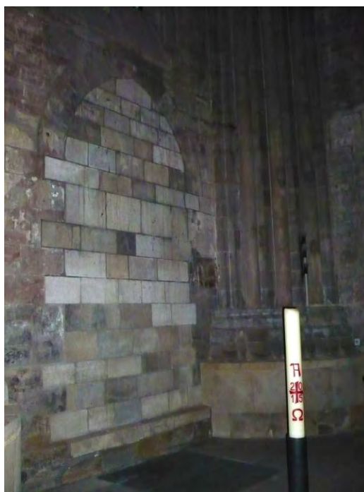
Abb. 29 b – Bauveränderung zugemauerte Fläche unter dem Lanzettfenster an der Ostwand des südlichen Querhauses. Blick auf spitzbogige Form, die an das Durchgangsportal zur Sakristei erinnert. (© ak)
