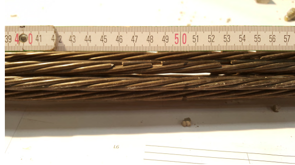
Abb. 3.33.: Spanndrahtbrüche am Spannglied (GR01)
