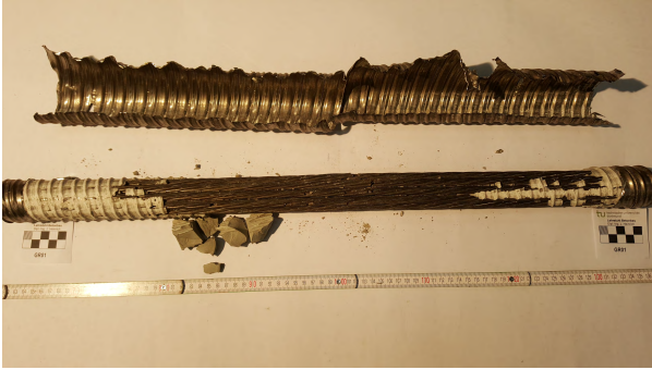
Abb. 3.32.: Freigelegtes Spannglied (GR01)
