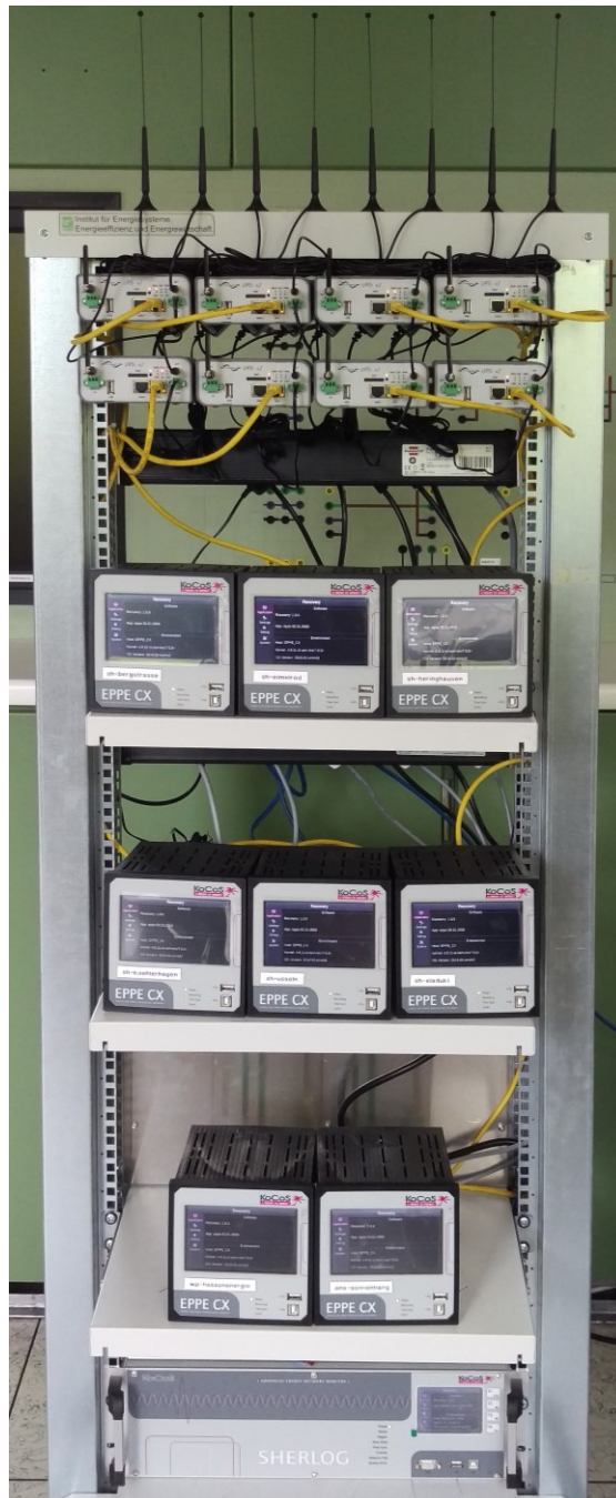
Abbildung 5.27: Komponenten für den Feldtest im Laboraufbau (oben: Mobilfunkrouter mit Antennen, Mitte: EPPE CX, unten: SHERLOG CRX, der DSL-Router ist nicht sichtbar)
