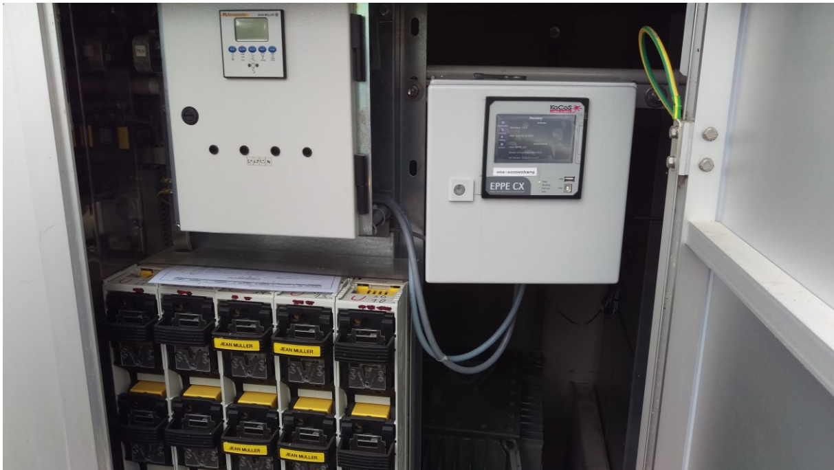
Abbildung 5.29: Ortsnetzstation ONS (Detail)
