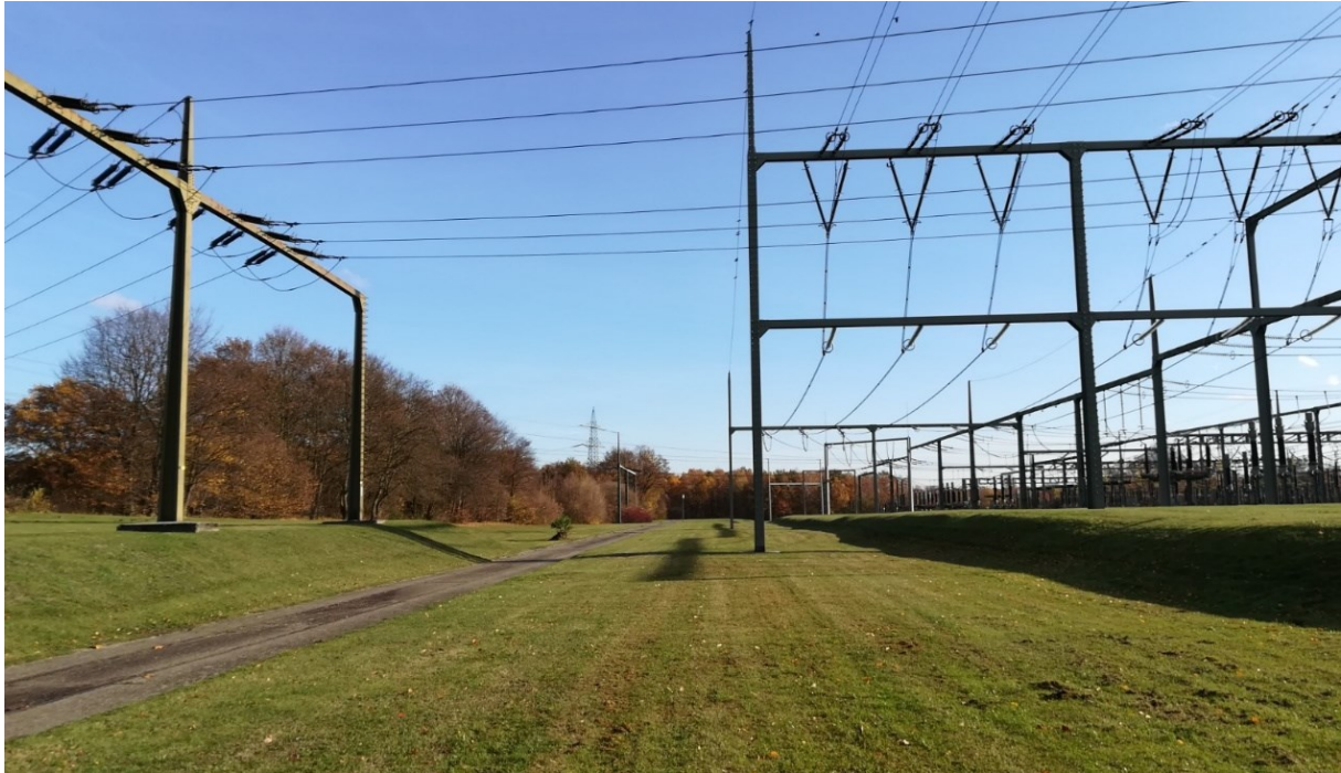
Abbildung 79 Umspannanlage Pöppinhausen in Castrop-Rauxel Amprion GmbH
