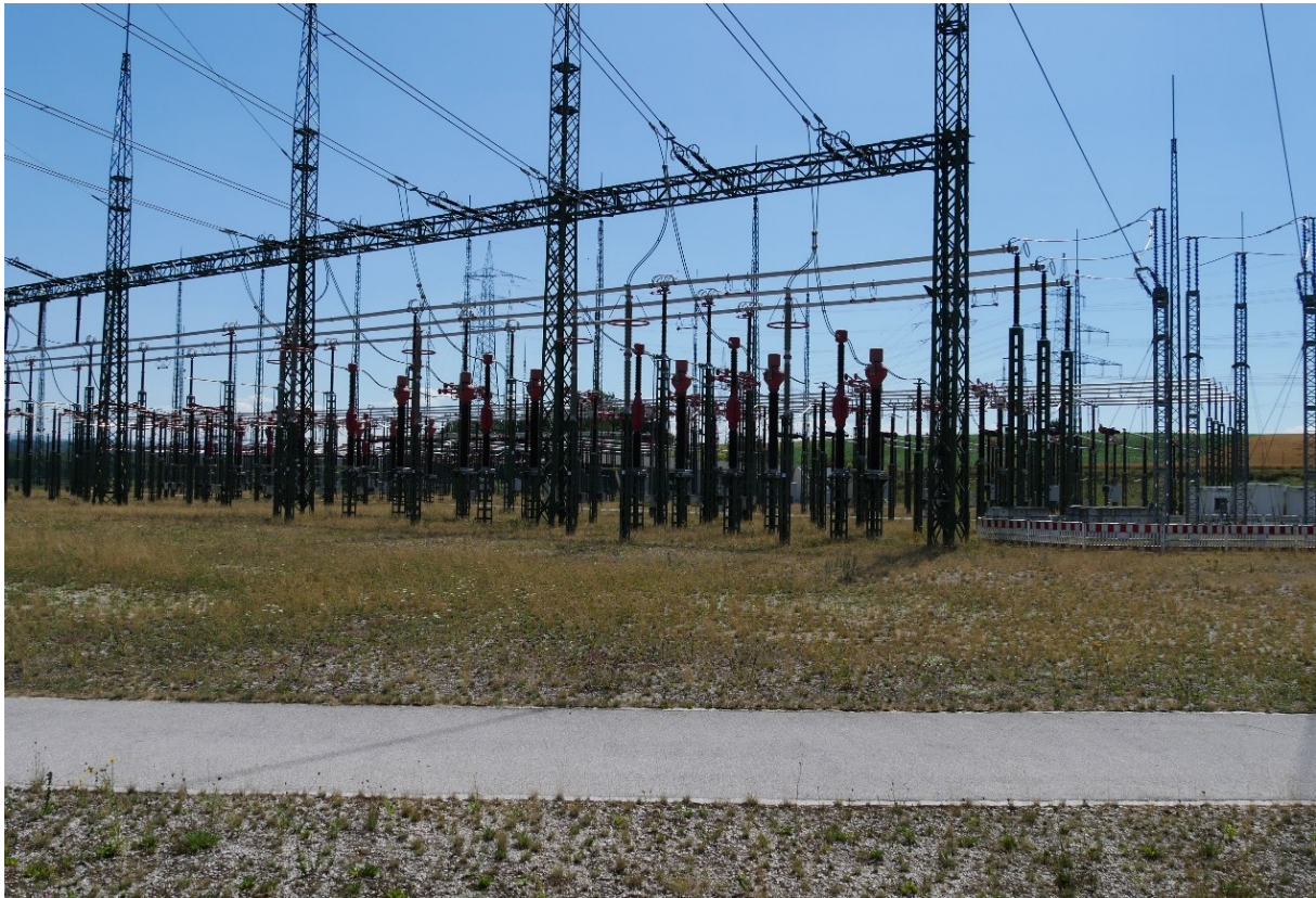
Abbildung 77 Begrünung Umspannanlage Kronstorf
