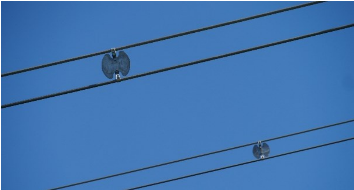
Abbildung 74 Vogelschutzmarker Bl. 152, Umspannanlage Kronstorf
