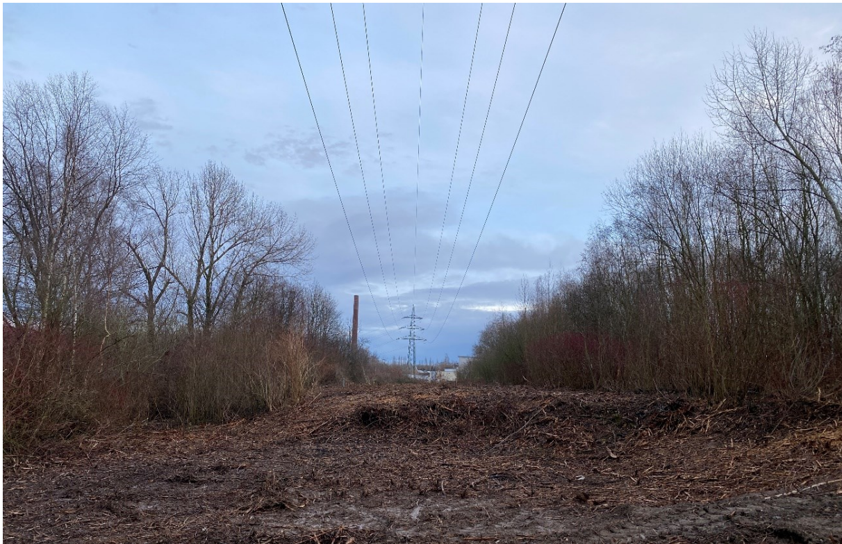
Abbildung 36 Kahlschlag und Verbleib des Schnittgutes im Schutzstreifen der 110-kV Leitung Eppendorf- Hattingen, Bl.1797
