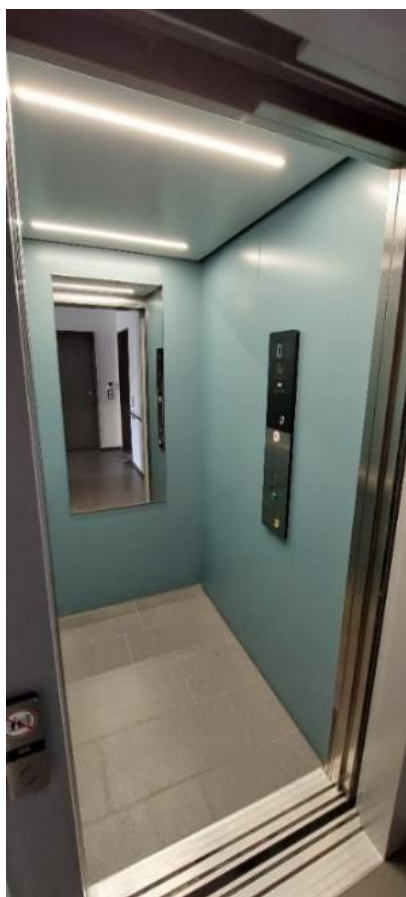
Abbildung 7 Aufzugskabine (Bauen für Menschen o.J.a)
