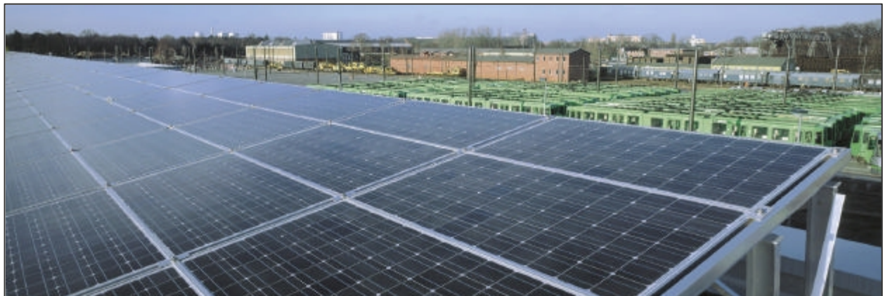
Abb. 39: Photovoltaikanlage auf dem Dach des Betriebshofs der üstra in Hannover-Leinhausen
