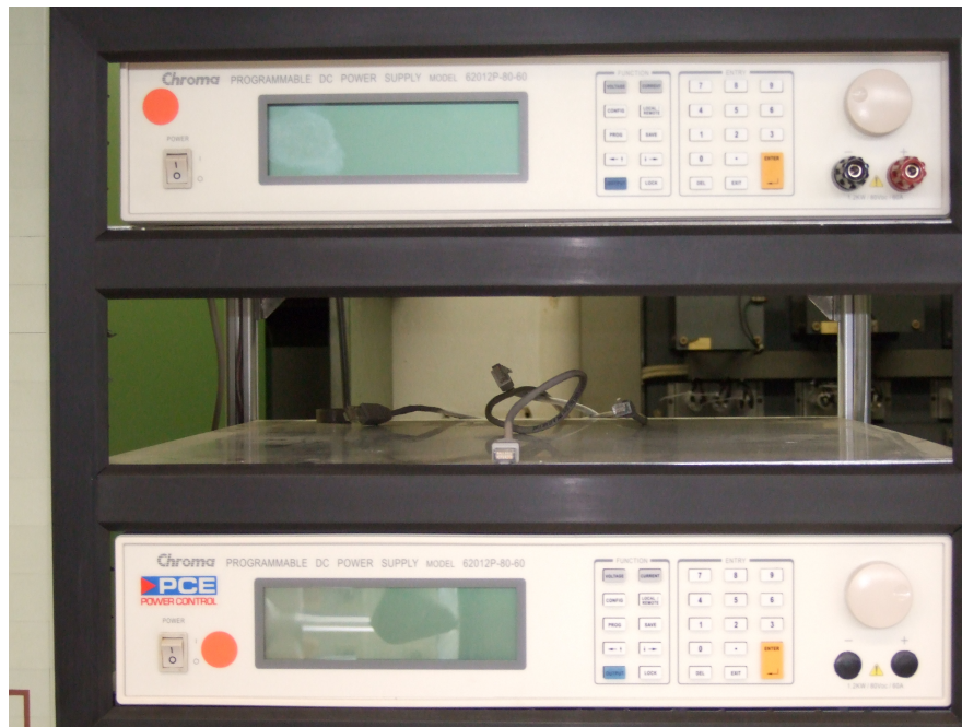
Abbildung 2.25: Gleichstromaggregate der PVA
