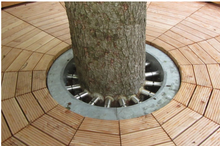
Abbildung 74: Direkte Verbindung von Baumschrauben in eine Umreifung an der zentralsymmetrischen Aussichtsplattform „Adlerhorst“, welche eine einzelne Weißtanne ( Abies alba ) als Tragstruktur nutzt.
