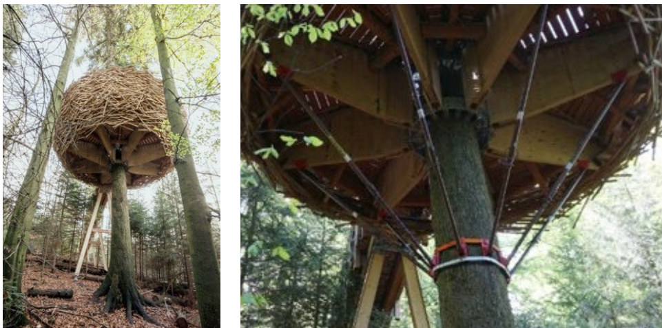
Abbildung 62: Aussichtsplattform "Adlerhorst" im Schwarzwald vor der Anbringung zusätzlicher Abstützung sowie danach.
