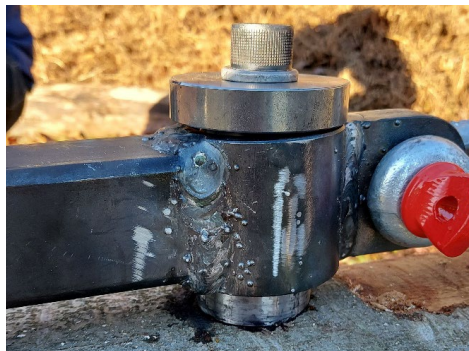
Abbildung 107: Anfangsschrägstellung infolge des Lochspiels zwischen Umwallungsabschnitt und Hülsen schon bei geringer Last.
