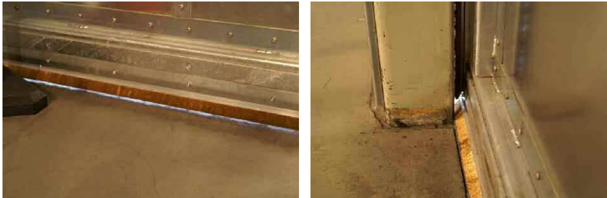
Abbildung 3.6: Mangelhaft ausgeführte Kontaktierung der nachträglich in die Vollmetallschirmung eingefügten Tür.
