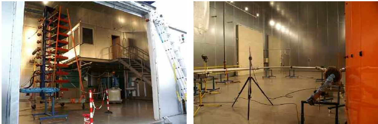
Abbildung 3.4: Voll geschirmtes Hochspannungslabor mit Einrichtungen zur Erzeugung von Blitzstoßspannungen bis 1 MV und Wechselspannungen bis 400 kV sowie Aufbauten zur hochspannungstechnischen Überprüfung von Kabeln. Der Bedieneraum ist in die Schirmung integriert.
