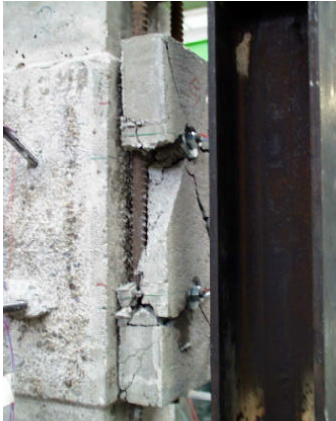
Abb. 8.44 : Versagen der Verstärkungsschicht
