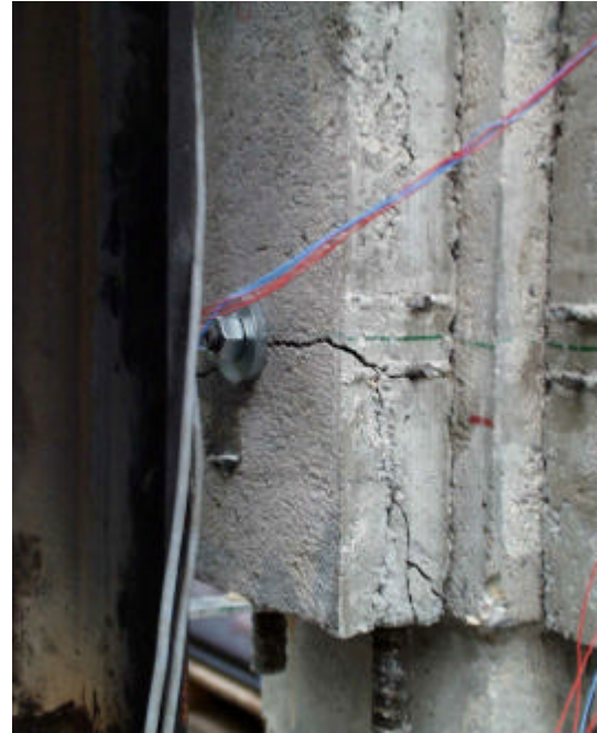
Abb. 8.41 : Risse im unteren Dübelbereich
