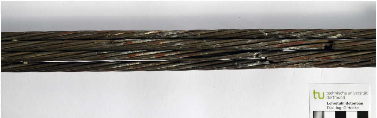
Bild A 3-45: SB01 – Spannstahl mit Drahtbrüchen
