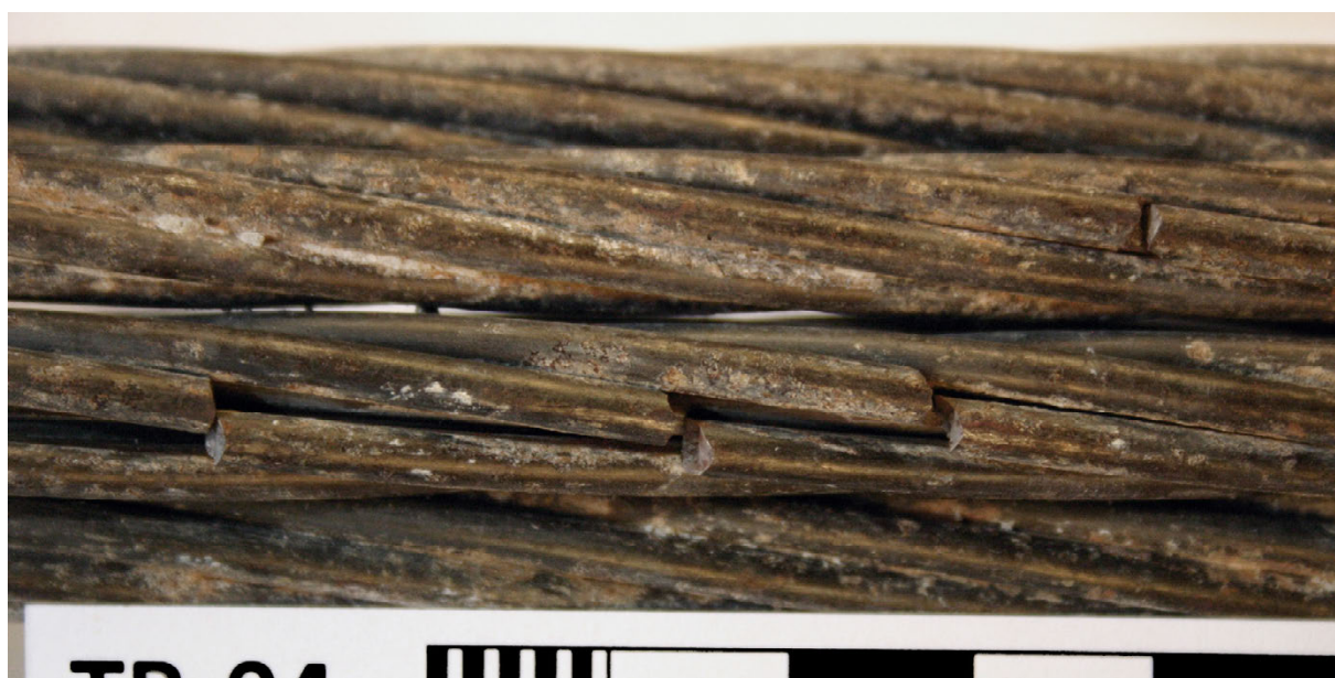
Bild A 3-34: TR04 – Detailaufnahme der Drahtbrüche
