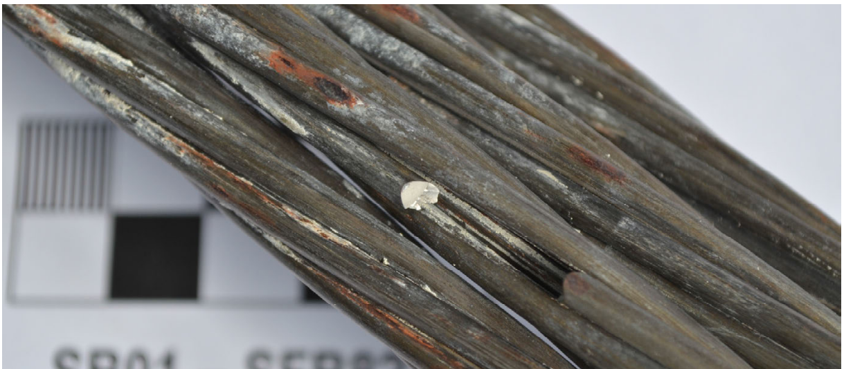
Bild A 3-46: SB01 – Detailaufnahme der Drahtbrüche
