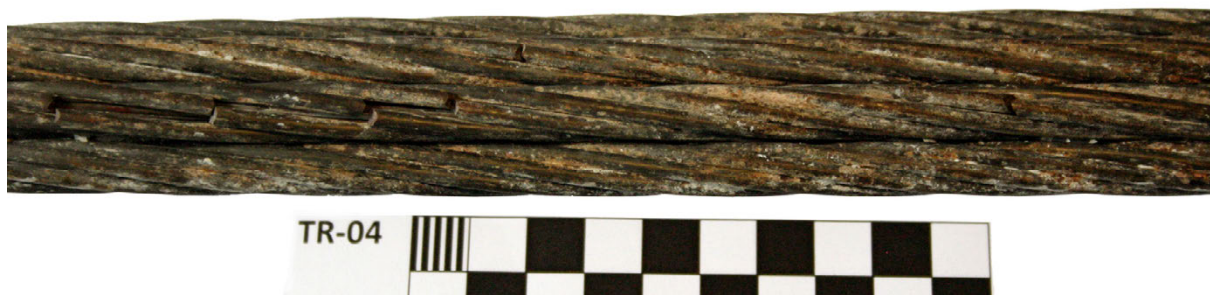
Bild A 3-33: TR04 – Spannstahl mit Drahtbrüchen
