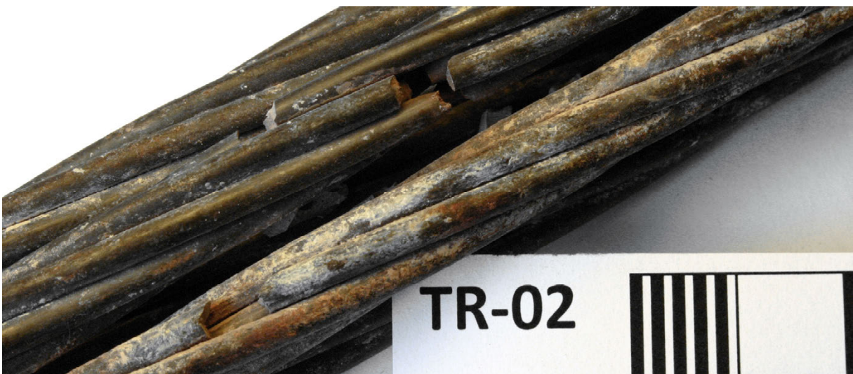
Bild A 3-22: TR02 – Detailaufnahme der Drahtbrüche
