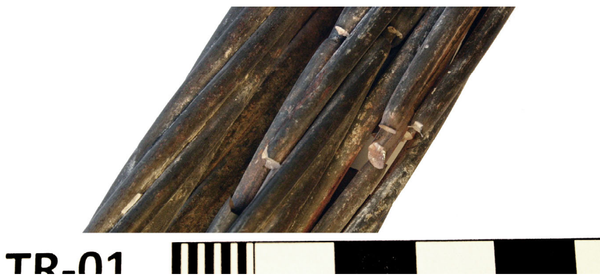
Bild A 3-16: TR01 – Detailaufnahme der Drahtbrüche
