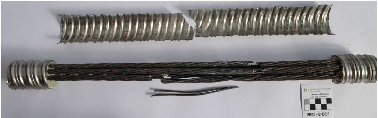
Bild A 3-50: SB02 – Entnommene Spannfitzen und Hüllwellrohr
