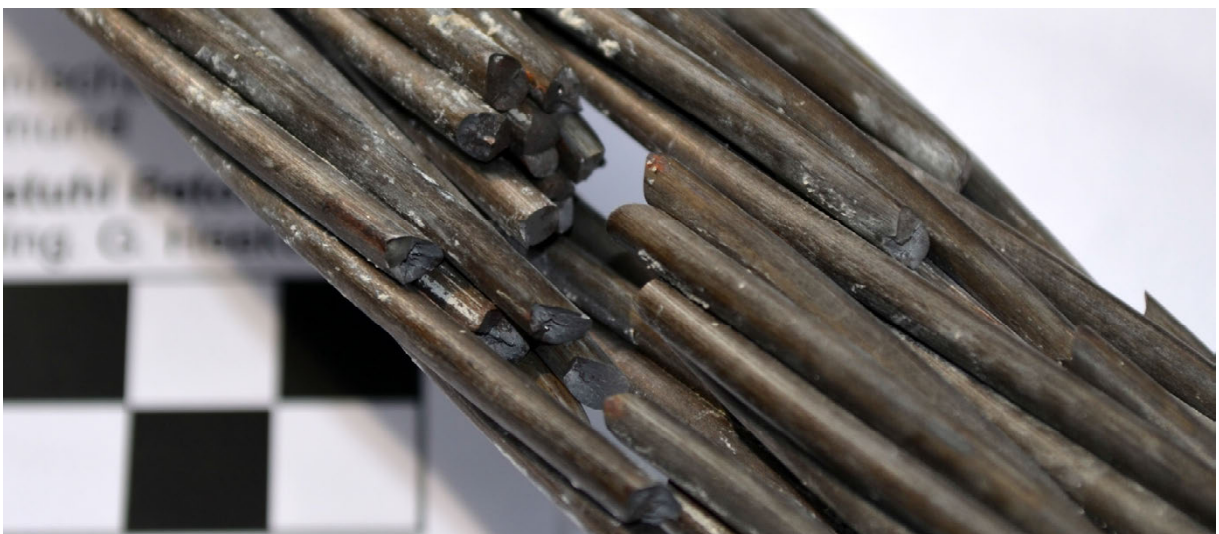
Bild A 3-58: SB03 – Detailaufnahme der Drahtbrüche
