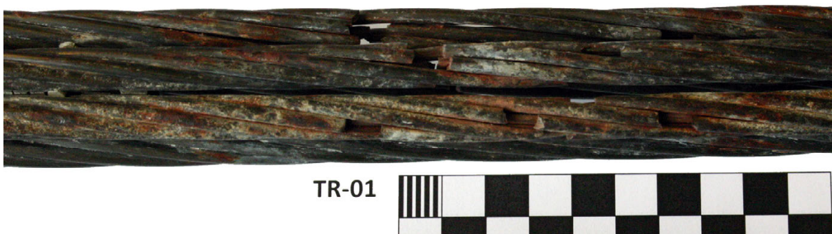
Bild A 3-15: TR01 – Spannstahl mit Drahtbrüchen
