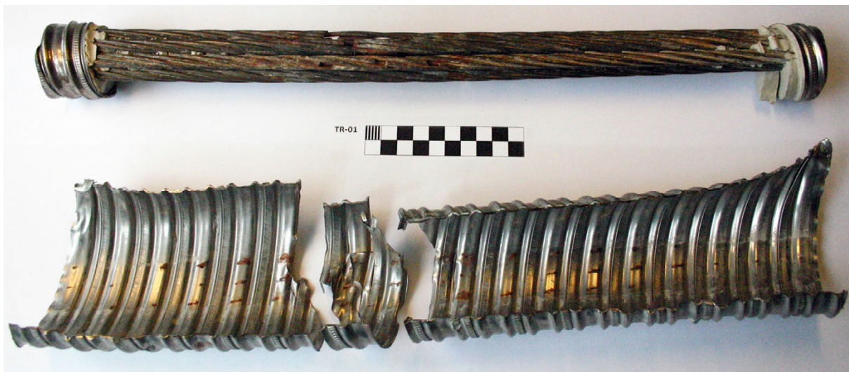
Bild A 3-14: TR01 – Entnommene Spannlitzen und Hüllwellrohr
