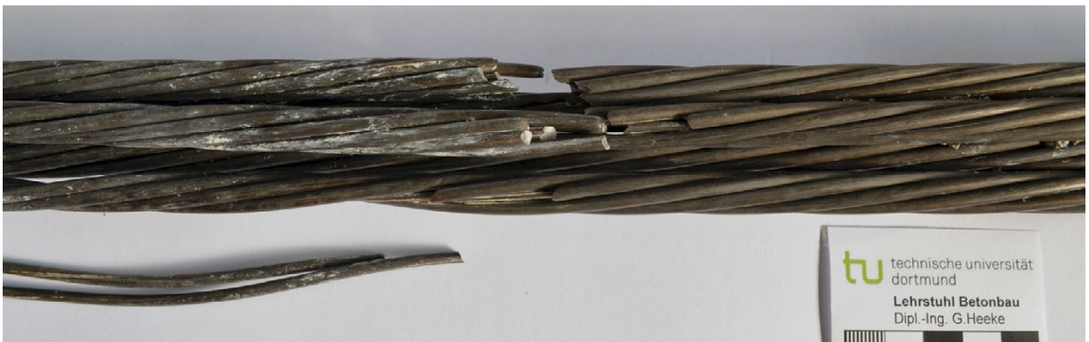
Bild A 3-51: SB02 – Spannstahl mit Drahtbrüchen
