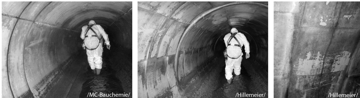
Bild 7-10: Zustand der Glassysteme nach 5jähriger Nutzung des Abwasserkanals
