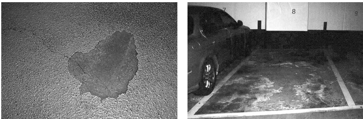
Bild 6–7: Links: Abplatzungen im OS 8-System von Objekt 4. Rechts: Schäden in der Phenolharzbeschichtung /Rau04/
