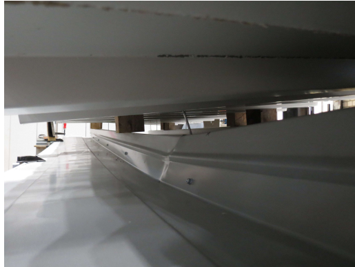
Bild 2.21: Typisches Versagensbild bei Biegedruckbeanspruchung der schmalen Obergurte und Befestigung der Außenschale mit Distanzbefestigern
