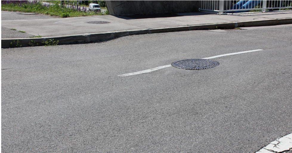
Abbildung 8.1: Ausbildung einer Setzungsmulde am Übergang zwischen Brückenende und Fahrbelag bei fehlender Schleppplatte [37]
